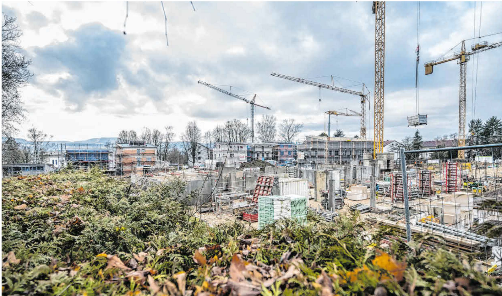
Unterhalb des Göppinger Hauptfriedhofs, in dem 21 000 Quadratmeter großen Wohngebiet Hohenstaufenstraße/Dürerstraße, schießen die Kräne aus dem Boden. 72 neue Etagenwohnungen entstehen hier. Die Nachfrage ist dennoch größer als das Angebot. Foto: Giacinto Carlucci
